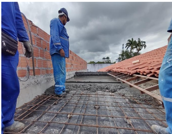
Armação de pilar ou viga de uma estrutura convencional de concreto armado em uma edificação térrea ou sobrado.
