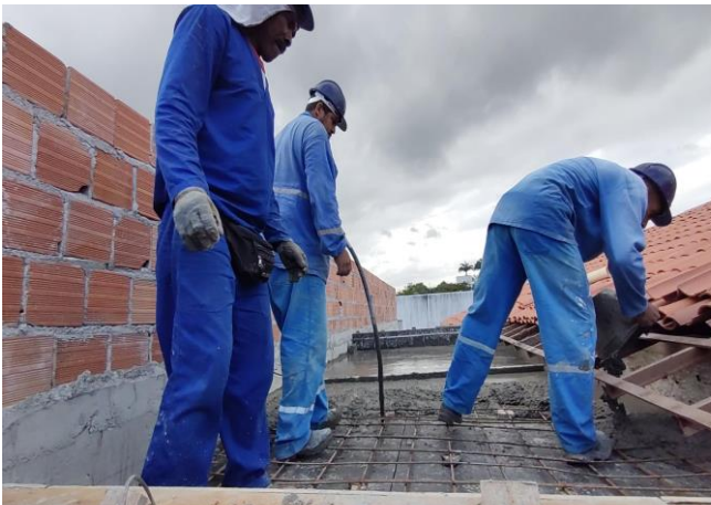
Lançamento com uso de baldes, adensamento e acabamento de concreto em estrutura.
