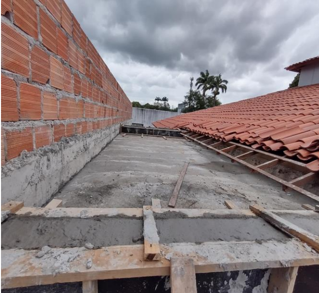
Concreto FcK = 30Mpa, traço 1:2,1:2,5 (Em massa seca de cimento / areia media / brita 1) – preparo mecânico com betoneira
